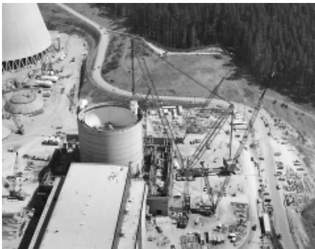
La planta que aparece en la foto es una de cuatro que empezaron a construirse en el estado de Washington y quedaron a medio acabar en los 1980, debido a que Paul Volcker subió los intereses a la estratosfera. (Foto: Washington Public Power Supply System (WPPSS)).
